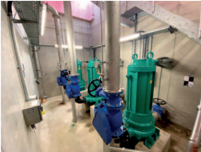
Die 3 Pumpen, die das Wasser des AZV zur KA Kaditz fördern
