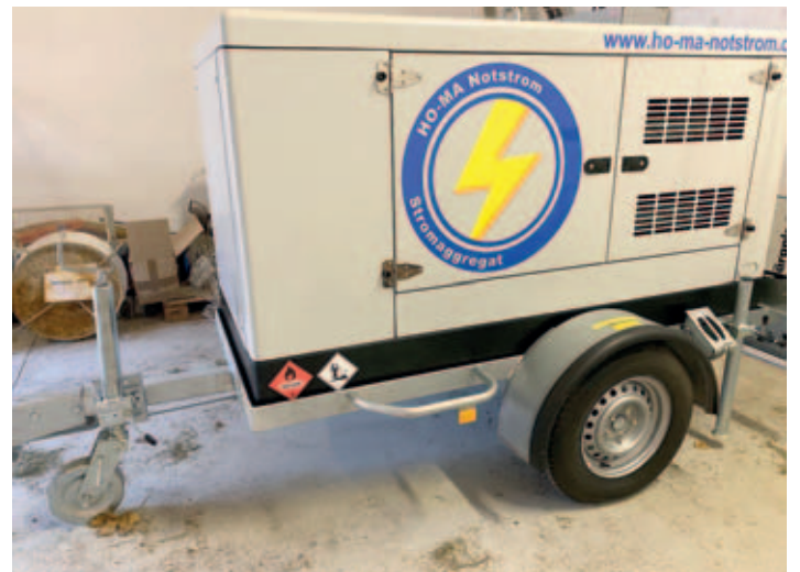
Das neu beschaffte Notstromaggregat (Netzersatzanlage)
